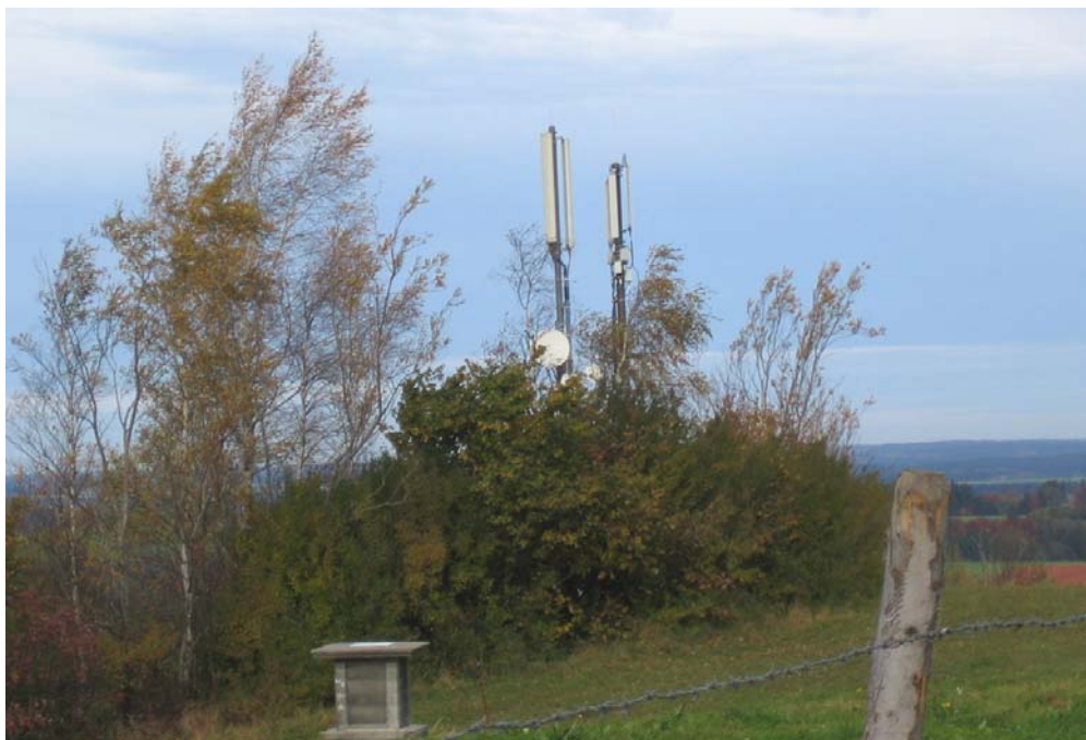
Abb. 1: Mobilfunksendeanlagen auf dem Wasserhochbehälter Opprechts
